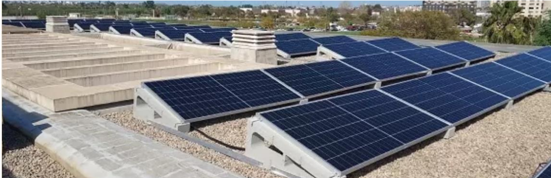
Imagen 14. Instalaciones de placas solares en cubierta.
